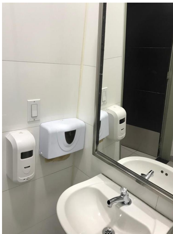
Imagen 2. Interruptor para personas en condición de discapacidad edificio central Aeronáutica Civil
